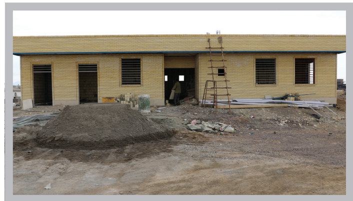
■ احداث مرکز بهداشت کار و آشنشانی معدن با زیر بنای ۲۰۰ متر مربع فضای اداری، درمانی و استراحتگاه مطابق با قوانین وزارت بهداشت و سازمان آشنشانی در محل شرکت
